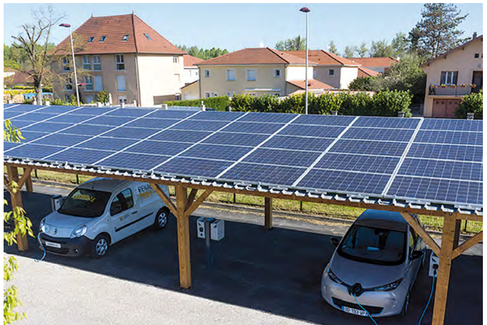
Un exemple d'ombrière de parking
